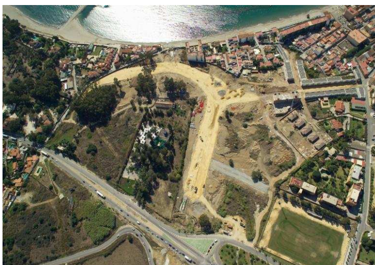
Fig. 208. Fotografía aérea de Villa Victoria una vez iniciadas las obras de construcción (Paisajes Aéreos S.L., 2004).
